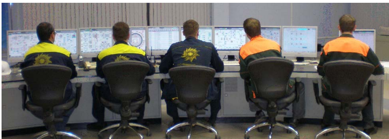
Рис. 2. БЦУ парогазового энергоблока ПГУ-325 ОАО «Ивановские ПГУ»
