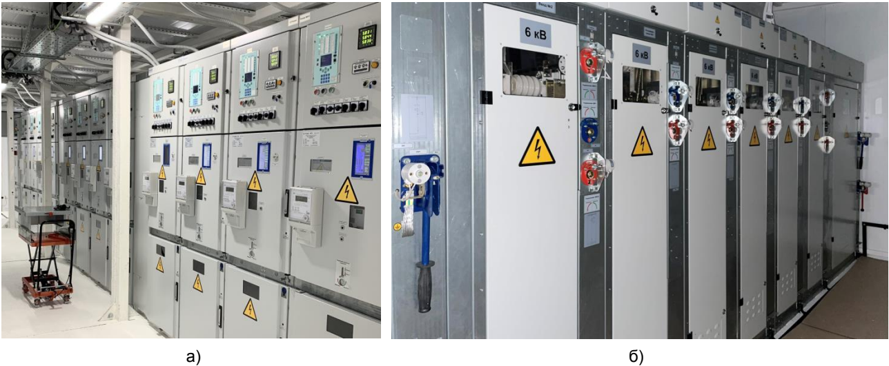
Рис. 1. Фрагменты современных распределительных устройств высокого напряжения (РУВН): а – на базе системы «Каскад»; б – на базе КСО-314
