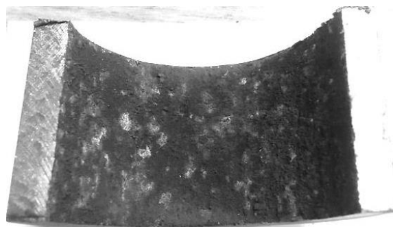
Рис. 2. Равномерные отложения на тыльной стороне экранных труб солевого отсека
